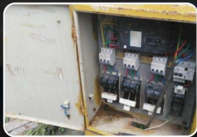
箱门未正常闭合
