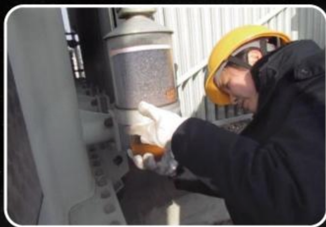
硅胶变色油杯破裂
