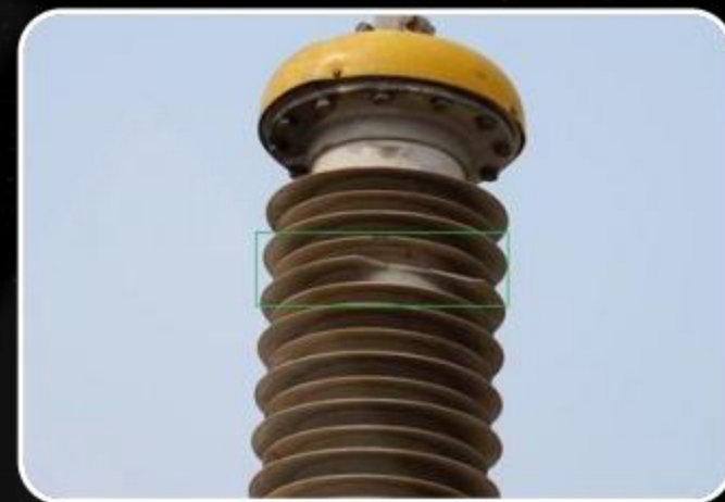
硅橡胶绝缘子伞裙破损
